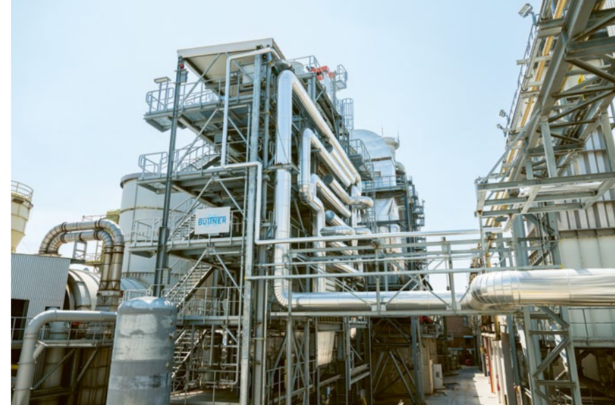
Der neue Thermalölkessel revolutioniert die erneuerbare Energieversorgung im Werk.
